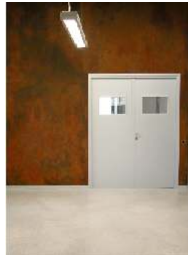
Vera Ruggine su muratura
